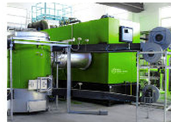
Une centrale automatisée et démarrée en Sicile
